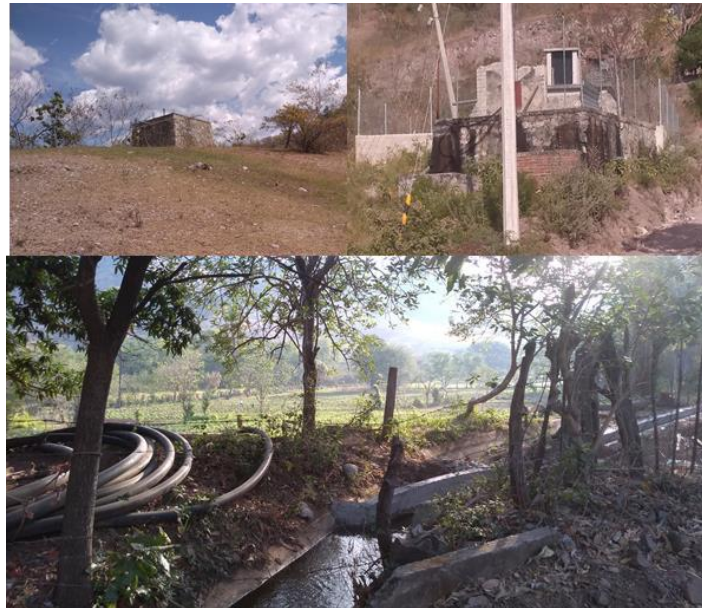
Figura No. 35 Infraestructura y equipamiento para captación y distribución de agua para uso humano y riego.
